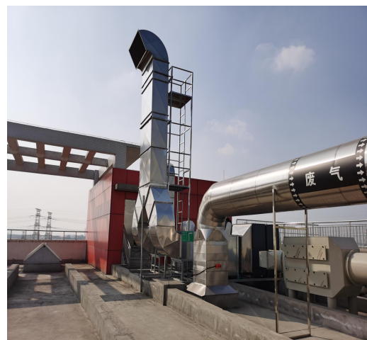
食堂+研发车间废气处理设施及排气筒（F10）
