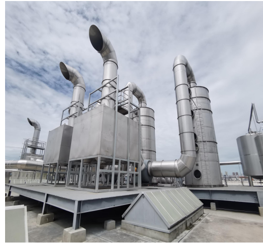
炒制车间废气处理设施及排气筒 (F04、F05)
