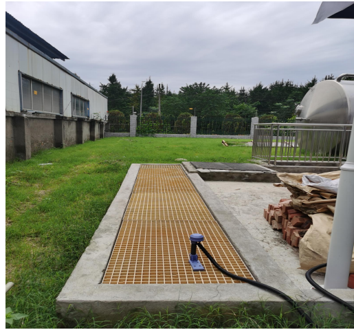
废水排放口 (W1)
