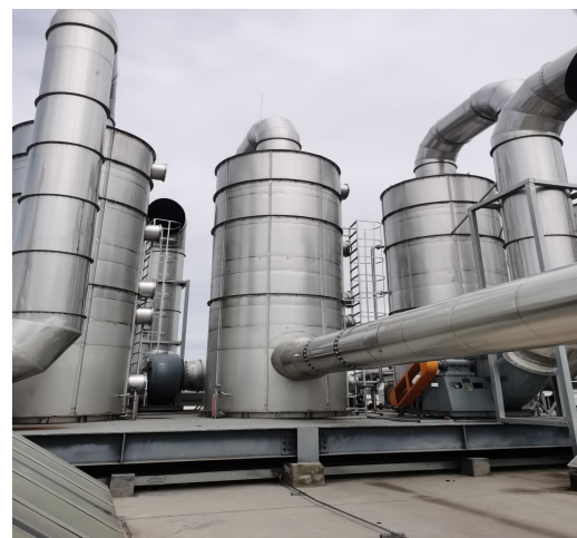
粉料车间废气处理设施及排气筒 (F07)
