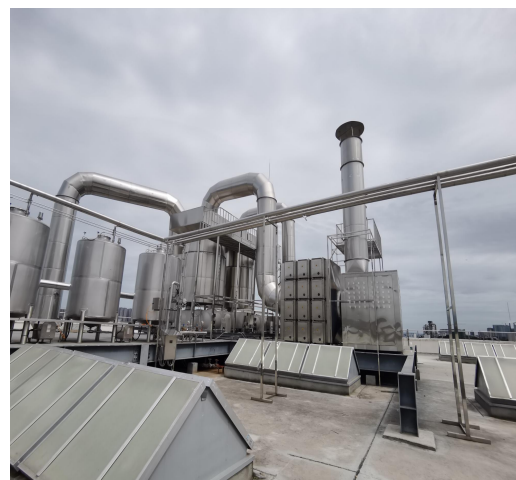
传统炒锅车间废气处理设施及排气筒 (F03)
