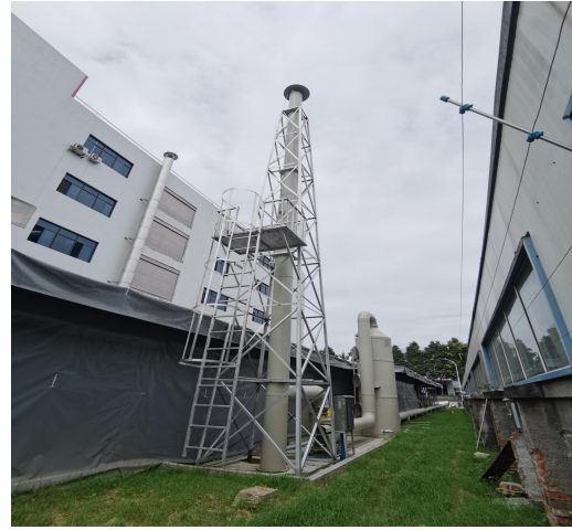
污水处理站废气处理设施及排气筒(F11)
