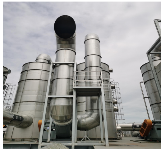
膏类反应区废气处理设施及排气筒 (F06)
