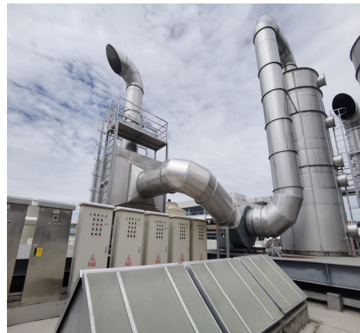
配料车间废气处理设施及排气筒（F08）
