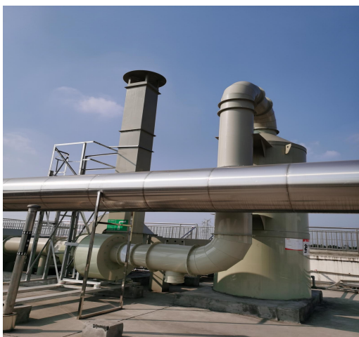
质检研发车间废气处理设施及排气筒（F09）
