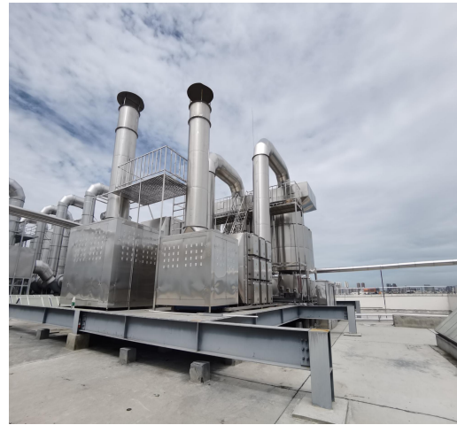
红油车间废气处理设施及排气筒 (F02)
