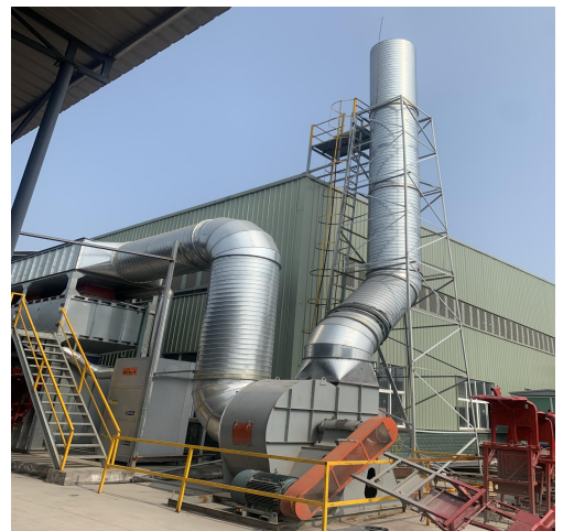
RCO 催化燃烧再生处理装置 及有机废气排气筒
