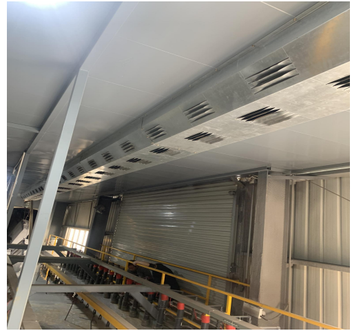
电泳工序通风管道
