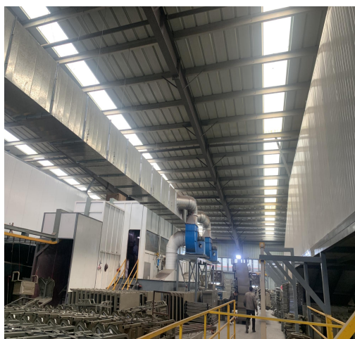
有机废气负压收集装置及输送管道
