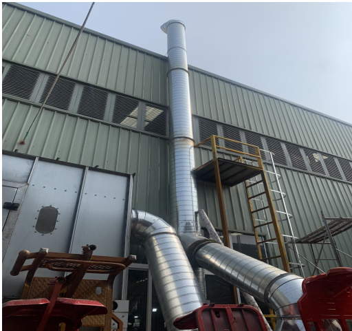
脉冲除尘装置及焊接废气排气筒
