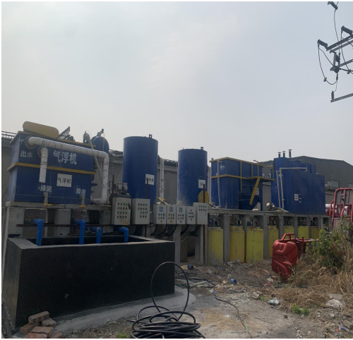
污水处理设施
