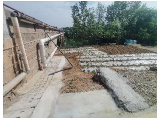
南杆大桥（跨越潼江河省级水产种质资源保护区核心区和梓潼县许州镇乡镇饮用水源保护区二级保护区）径收集系统
