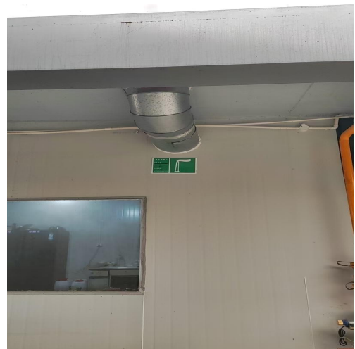
食堂油烟排气筒
