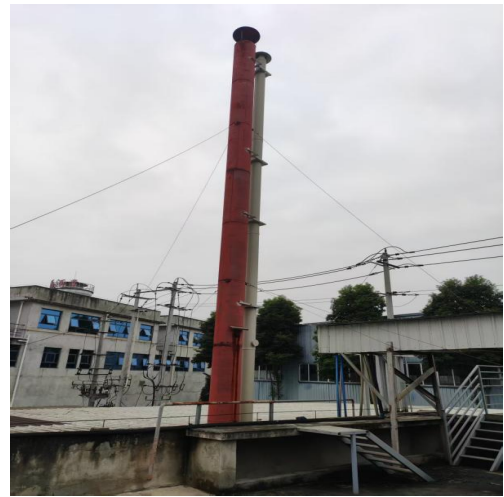
燃烧废气排气筒
